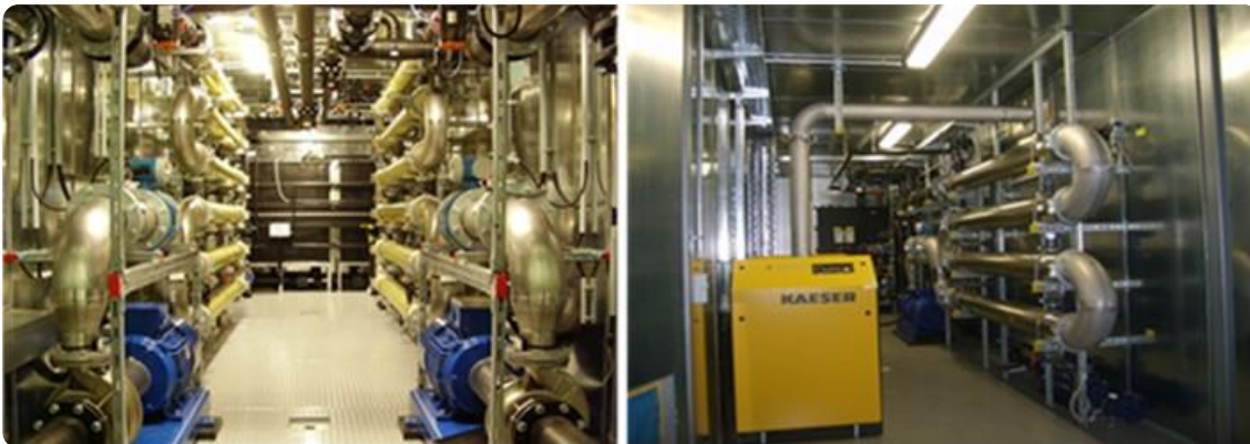
Figura 4: Interior de dos contenedores de UF. Izda.: Dos calles; Dcha.: Calle individual.
