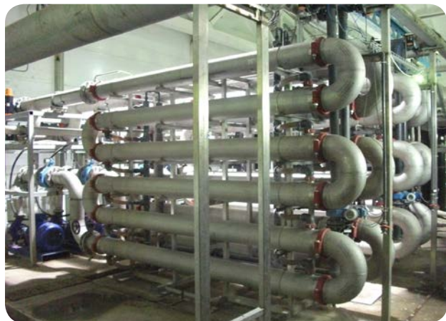
Externe UF-Membranen als Teil des Hochleistungs-MBRs
