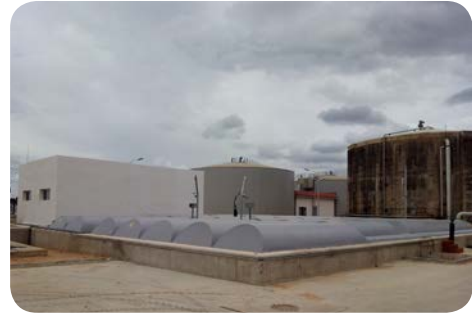
Beispiel: Kläranlage Badajoz / ES mit einem BIOMOX®-CFR
