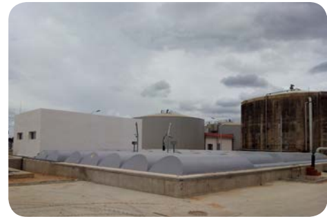
Beispiel: Kläranlage Badajoz / ES mit einem BIOMOX®-CFR
