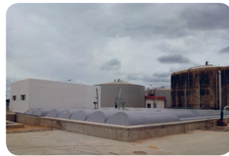
Beispiel: Kläranlage Badajoz / ES mit einem BIOMOX®-CFR
