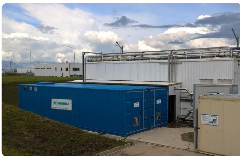
1) Station de zéro rejet liquide (« ZLD ») terminée, avec bioréacteur en arrière-plan et conteneurs d'ultrafiltration et d'osmose inverse au premier plan.
